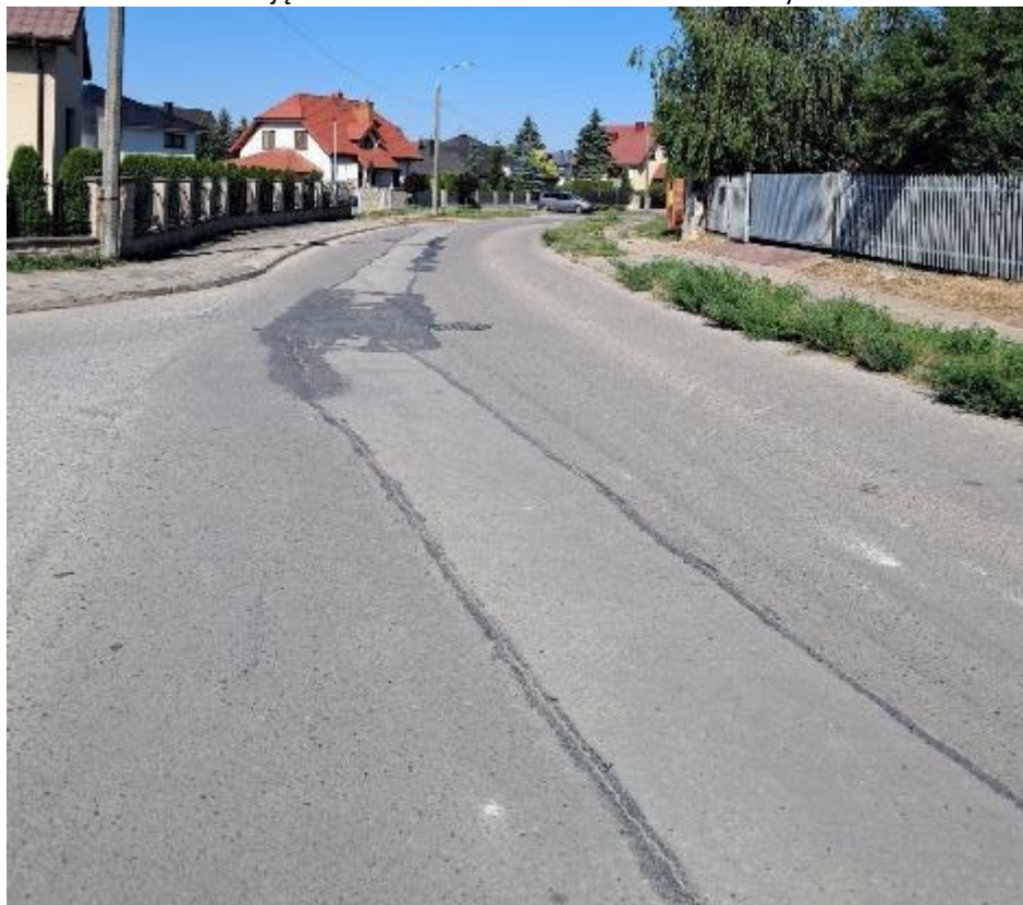
Zdjęcie 13 Morawica ul. Parkowa – stan obecny
