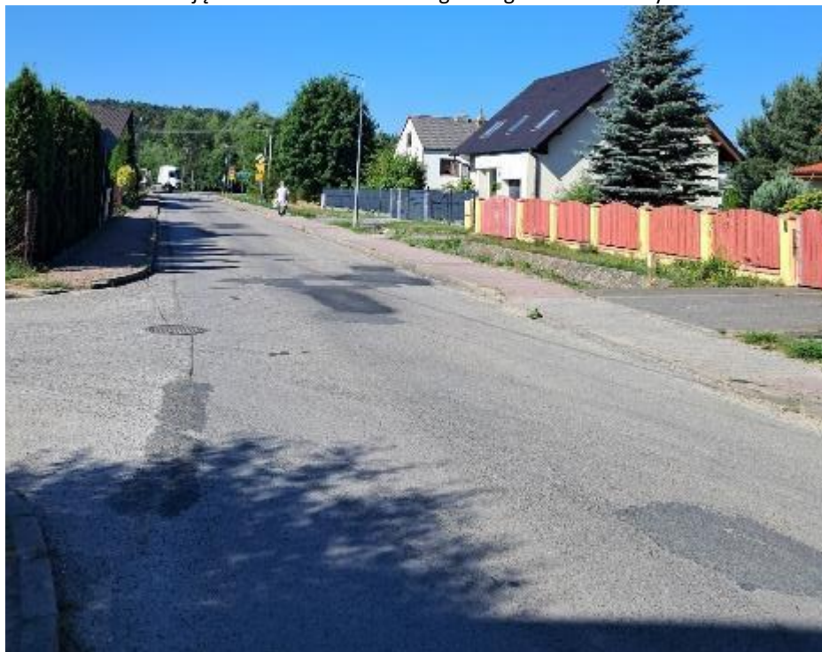
Zdjęcie 14 Morawica ul. Ściegiennego – stan obecny
