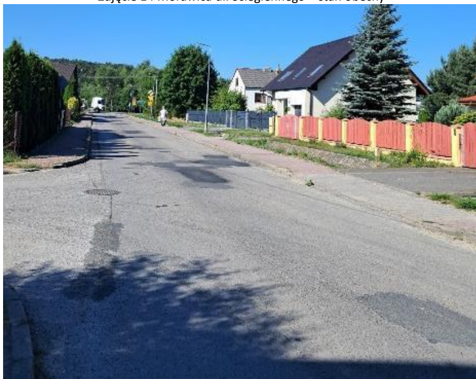
Zdjęcie 14 Morawica ul. Ściegiennego – stan obecny
