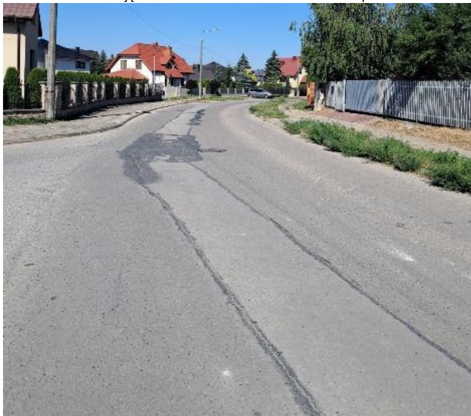
Zdjęcie 13 Morawica ul. Parkowa – stan obecny
